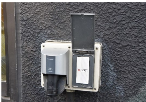
EV用200V受電コンセント
