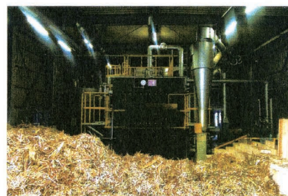
バイオマスボイラー
