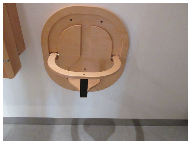
トイレに設置された木製ベビーチェア
