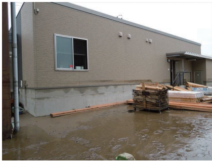
水の跡が付いた事務所の壁
